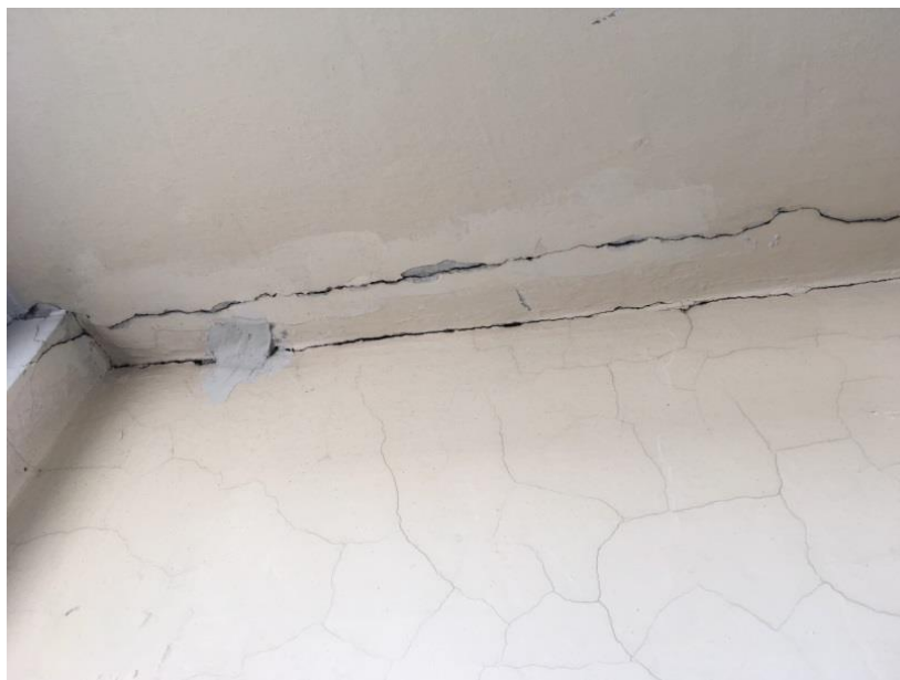
1. ŁĄCZNIK – ZARYSOWANIE SUFITU W MIEJSCU POŁĄCZENIA ŁĄCZNIKA Z BUDYNKIEM
