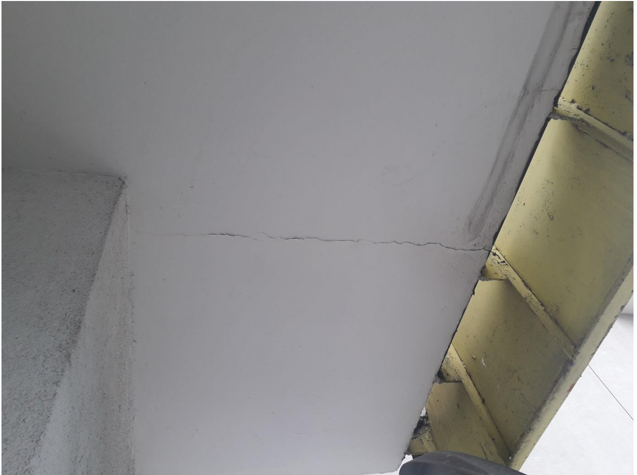
8. ZARYSOWANIE PŁYTY BALKONOWEJ
