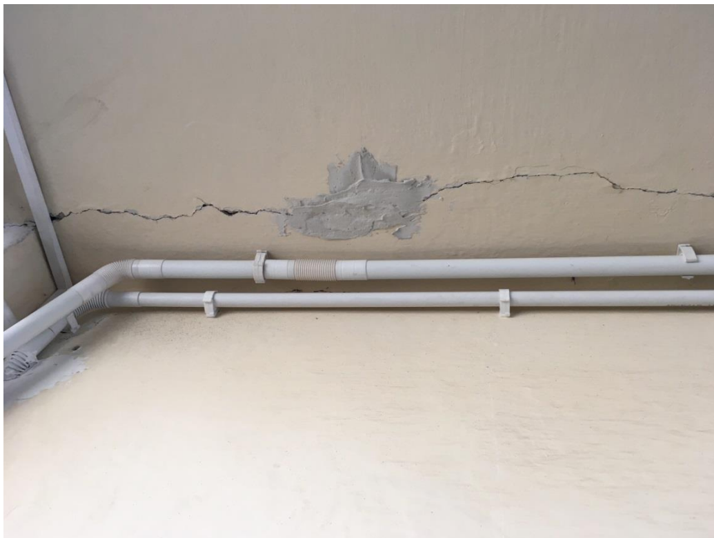
5. ŁĄCZNIK – ZARYSOWANIE SUFITU W MIEJSCU POŁĄCZENIA ŁĄCZNIKA Z BUDYNKIEM
