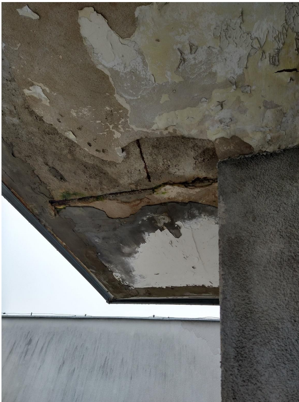
9. BRAK OTULINY PRĘTÓW ZBROJENIOWYCH PŁYTY BALKONOWEJ / KOROZJA ZBROJENIA
