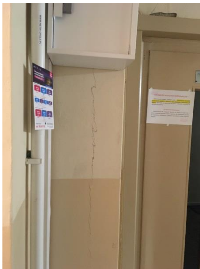
2. ŚCIANA KORYTARZOWA – WIDOCZNE ZARYSOWANIA W OBRĘBIE SZYBU WINDY
