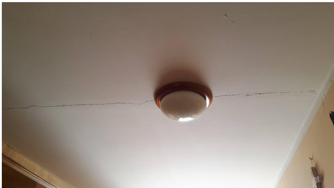
6. ZARUSOWANIE SUFITU W LOKALU MIESZKALNYM
