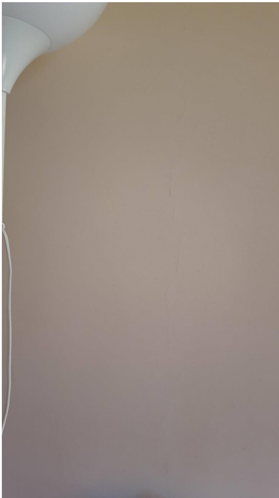
7. ZARYSOWANIE ŚCIANY W LOKALU MIESZKALNYM
