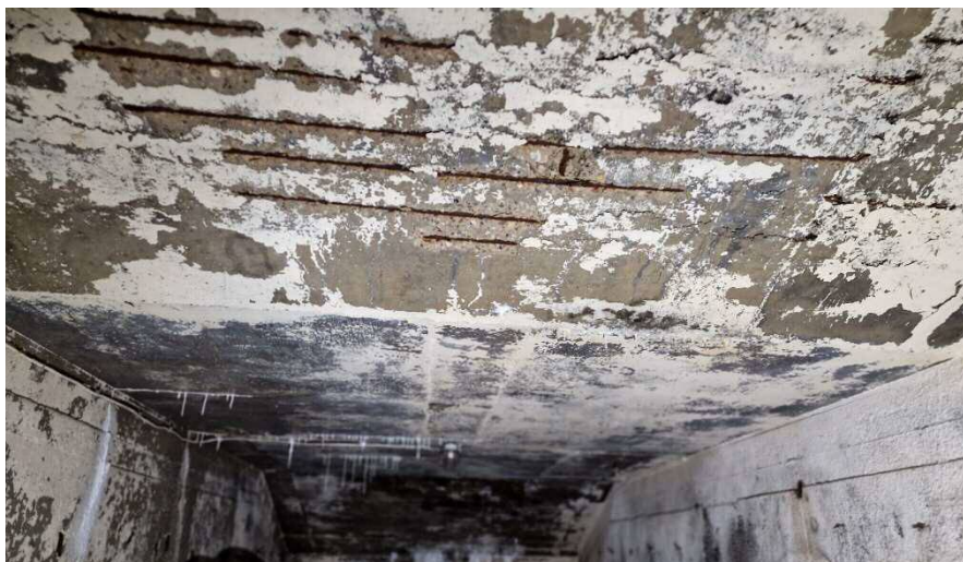
Fot. 11. Korozja prętów zbrojeniowych biegu schodowego od spodu (między osiami 20 i 21)
