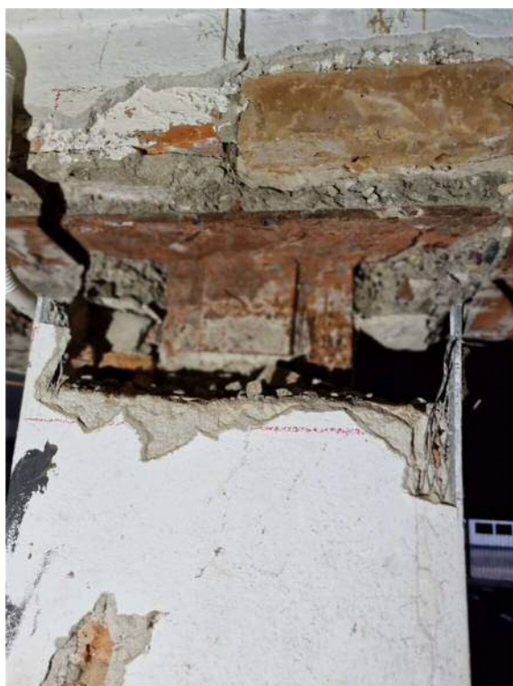
Fot. 9. Połączenie słupa stalowego z podciągami stalowymi po odkrywce betonu
