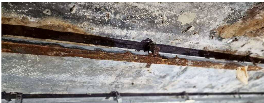
Fot. 6. Szczegół skorodowanego ceownika do montażu płyt cementowo-włóknowych
