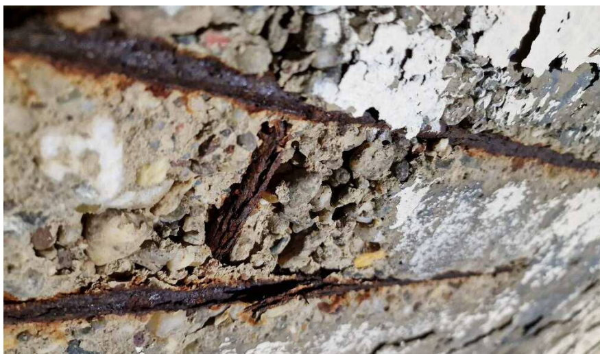
Fot. 12. Szczegół korozji prętów zbrojeniowych – duża destrukcja prętów (między osiami 20 i 21).
