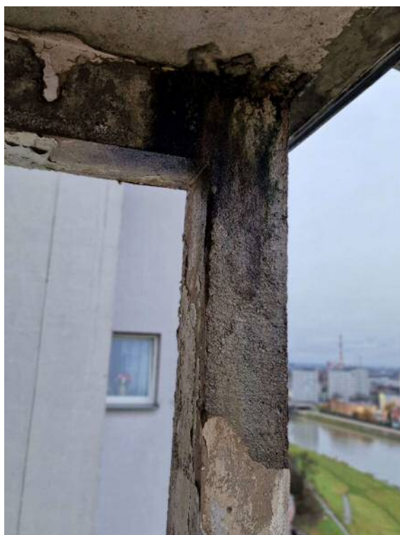
Fot. 25. Odpadanie tynku ze słupie ramy, silne zamakanie słupa i rygla ramy (lokal 5/38)
