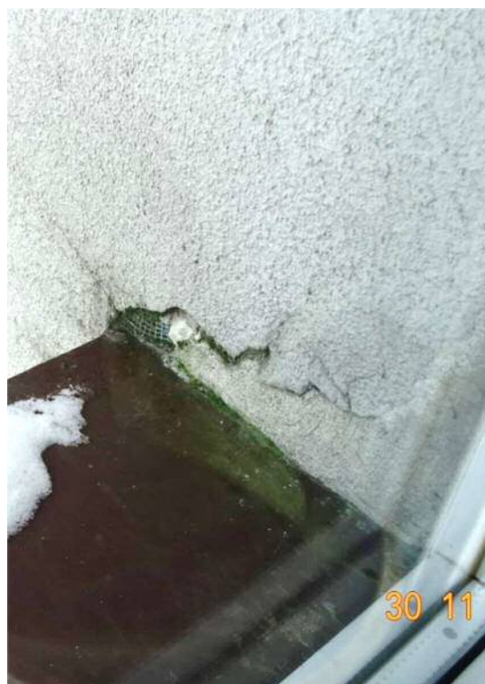
Fot. 42. Uszkodzenia tynku zewnętrznego przy parapecie w lokalu 5/8
