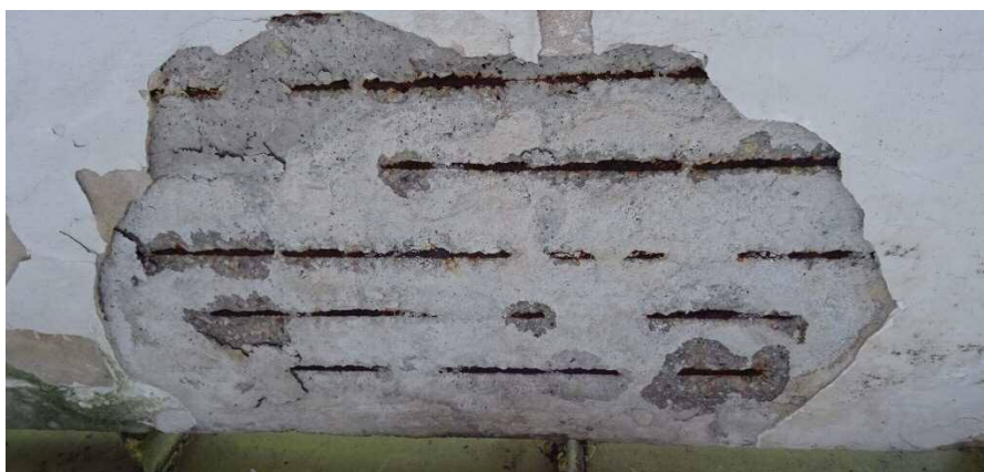
Fot. 22. Odpadnięcie tynku i otulenia prętów płyty balkonowej od spodu, powodujące odsłonięcie na czynniki atmosferyczne zbrojenia nośnego (lokal 5/12)
