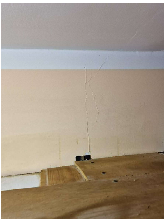
Fot. 41. Zarysowanie (pęknięcie) pionowe ściany w lokalu 6/34
