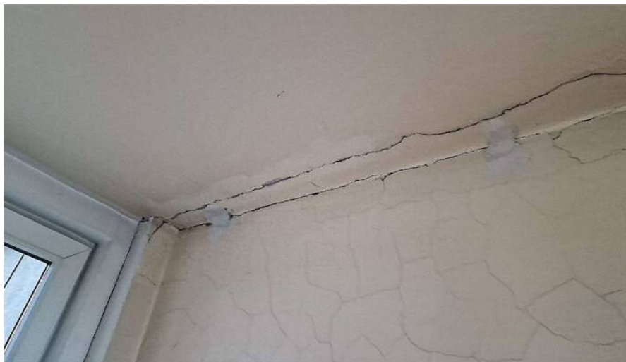
Fot. 34. Podwójne pęknięcie na suficie przy ścianie budynku nr 6
