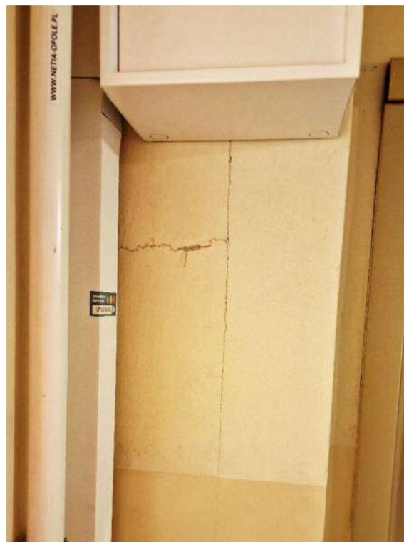
Fot. 40. Przykładowe inne pionowe pęknięcie przy szybie windowym
