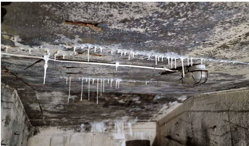
Fot. 13. Stalaktyty wodorotlenku wapnia w wyniku przecieku wody przez płytę biegu schodowego (między osiami 20 i 21)
