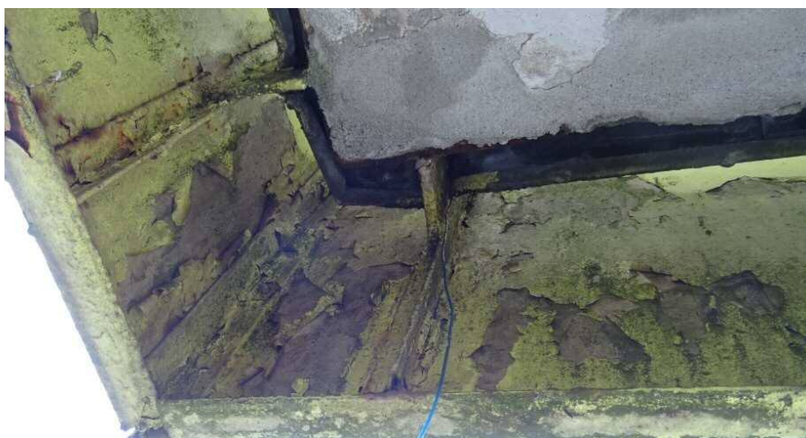
Fot. 17. Bardzo zużyta powłoka malarska balustrady balkonowej (lokal 5/12)
