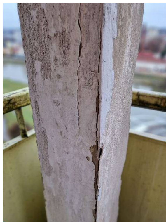
Fot. 26. Szczegół spękania i odpajania się tynku od słupa ramy (lokal 5/38)
