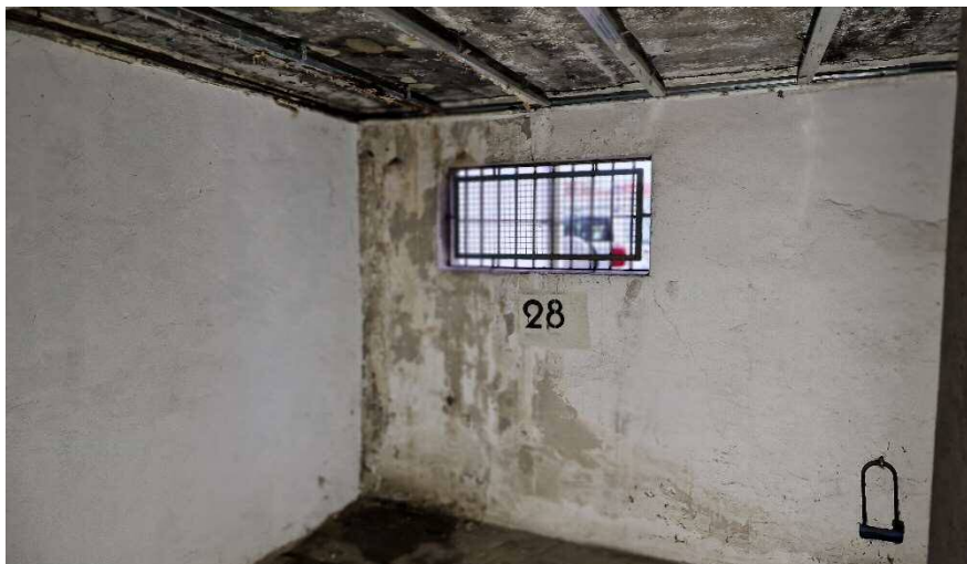
Fot. 16. Zawilgocenia muru w osi 21 przy osi N
