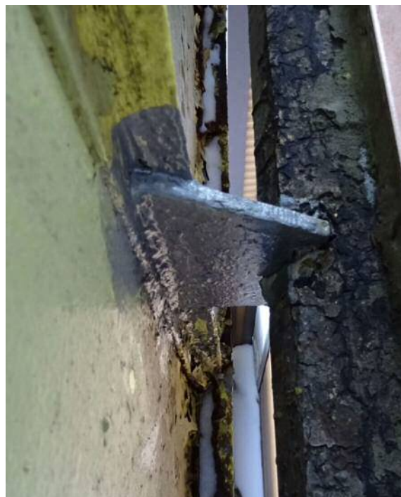
Fot. 21. Rozwiązanie obróbki blacharskiej umożliwiające zaciekanie wody do spawu marki połączonej z blachą (lokal 5/8)
