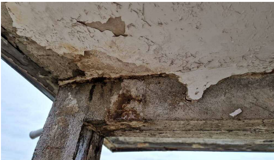
Fot. 24. Odpadanie tynku, ślady starych napraw naroża płyty, zamakanie ramy wsporczej i ślady rdzy na ryglu ramy (lokal 5/38)
