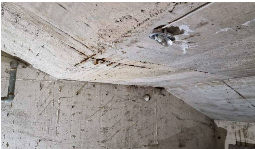
Fot. 14. Lokalna korozja prętów zbrojenio- wych biegu schodowego (między osiami 8-10)
