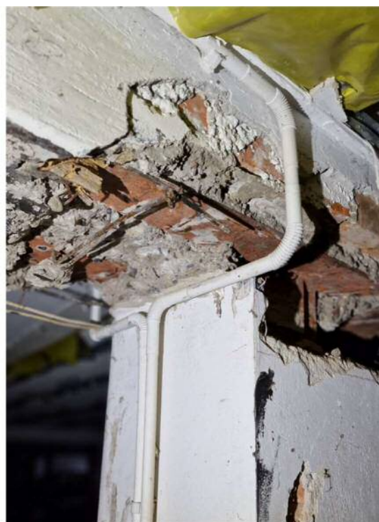
Fot. 10. Belka stalowa po odkrywce betonu
