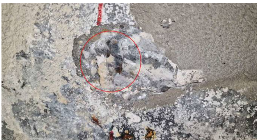
Fot. 44. Powierzchnia pręta w odkrywce betonu (w kółku) w okolicach punktu P2 bez śladów korozji
