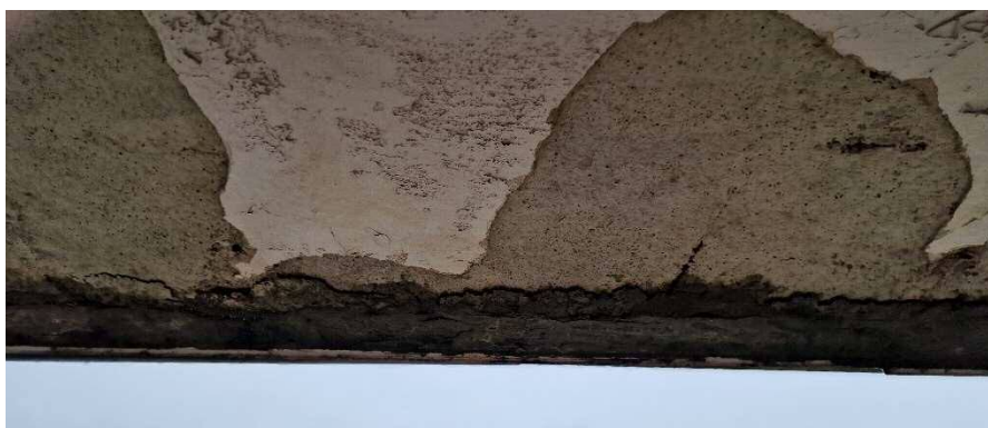
Fot. 23. Odpadnięcie tynku z płyty balkonowej od spodu, ślady starych napraw naroża płyty (lokal 5/38)
