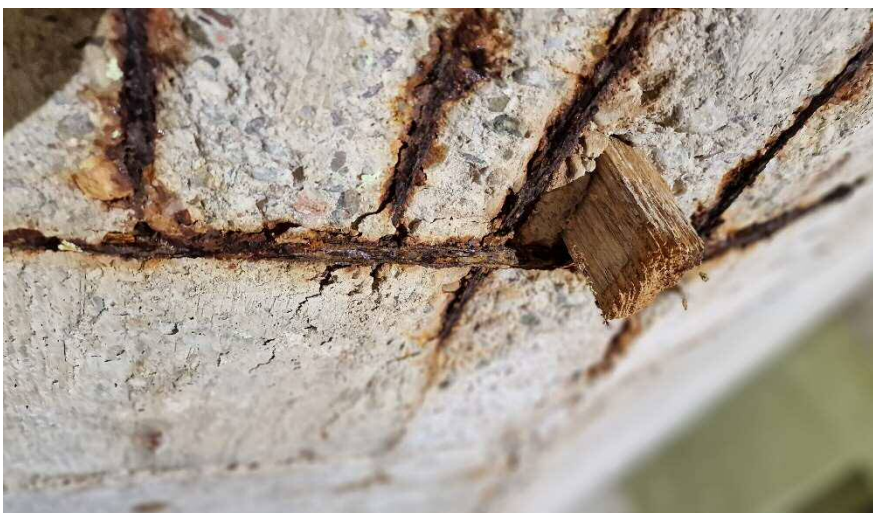
Fot. 15. Szczegół korozji prętów zbrojenio- wych – silna lokalna destrukcja (między osiami 8-10)
