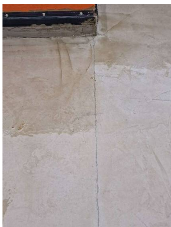
Fot. 29. Pęknięcie powłoki naprawczej nad ścianą w osi 3 w lokalu 6/40
