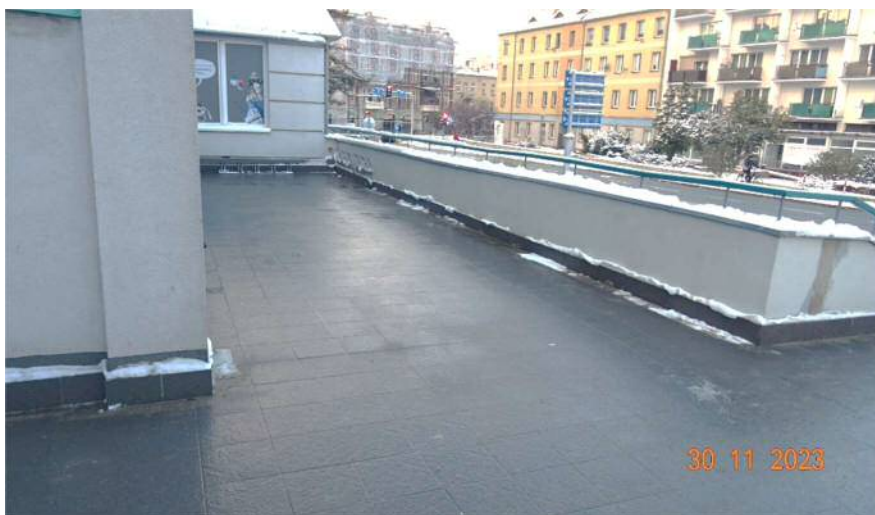
Fot. 4. Górna powierzchnia stropu nad garażem wykończona płytkami ceramicznymi.
