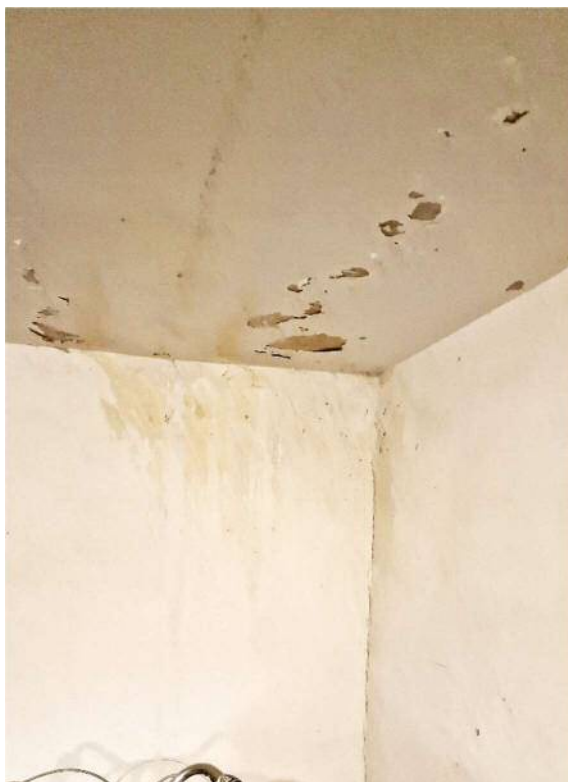
Fot. 37. Zacieki i przesączenia w kondygnacji przyziemia na ścianie w osiach F/9-11
