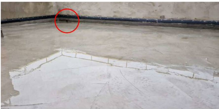
Fot. 27. Stojąca woda na powierzchni tarasu z małymi otworami odwodniającymi zaznaczonymi w kółku (lokal 6/40)
