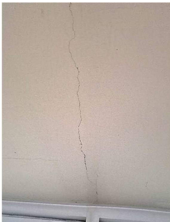
Fot. 35. Pęknięcie na suficie
