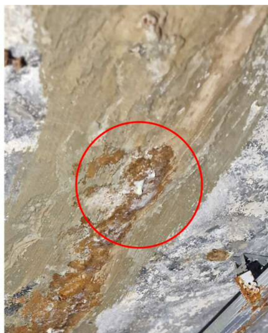
Fot. 8. Szczegół stalaktytu powstałego z wodorotlenku wapnia wypłukiwanego z betonu płyt stropowych
