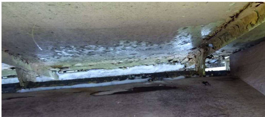
Fot. 18. Gromadzenie się śniegu i wody na dolnym poziomym kątowniku ramki balustrady balkonowej (lokal 5/12)
