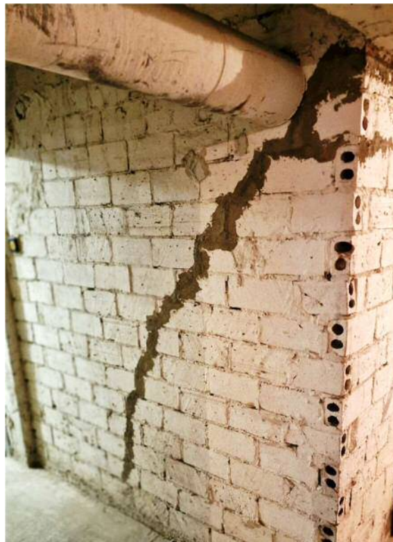
Fot. 38. Naprawione ukośne pęknięcie komórki lokatorskiej
