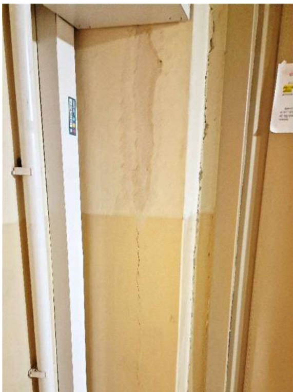
Fot. 39. Pionowe pęknięcie przy szybie windowym na 11 piętrze - naprawione
