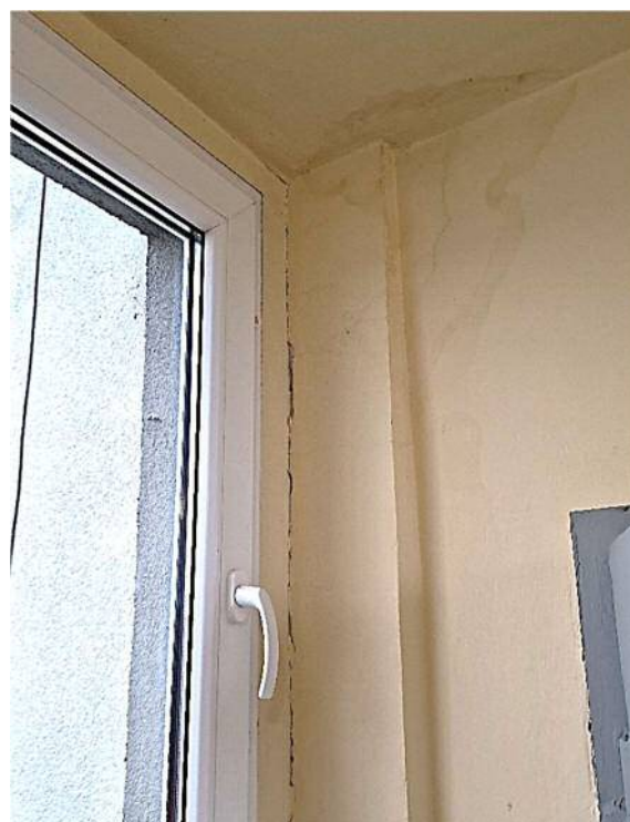
Fot. 36. Pęknięcie przy oknie wraz zaciekiem
