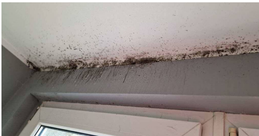
Fot. 32. Zagrzybienie nadproża (lokal 5/38)
